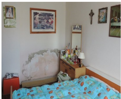
4. Izbijanje vlage sa suprotne strane zida
