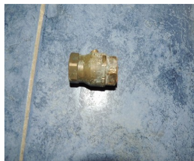
3. Oštećeni dio cijevi
