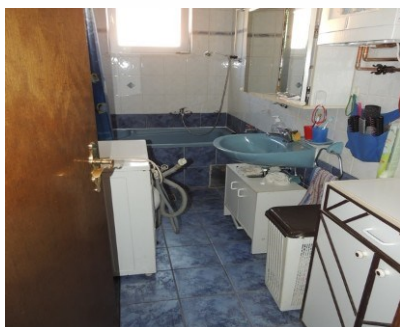
1. Puknuće cijevi u kupaoni
