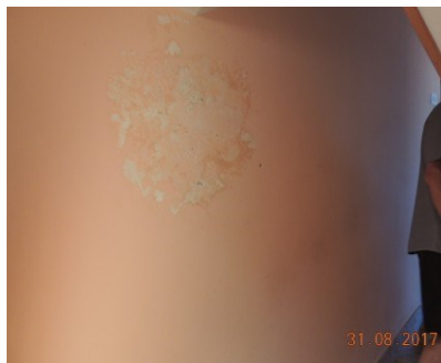
5. Izbijanje vlage uslijed puknuća cijevi u zidu
