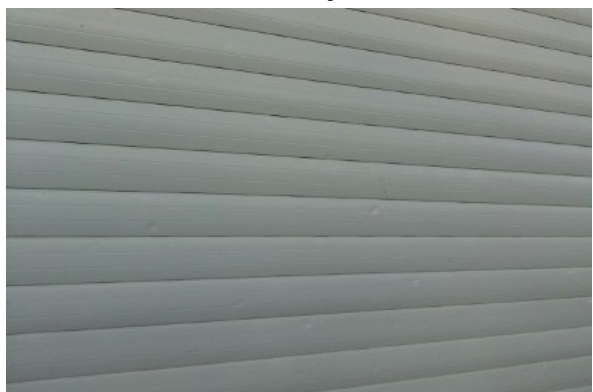
5. Oštećenja na roletama uslijed tuče
